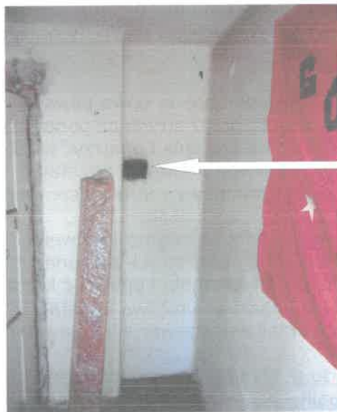
W pokoiku na strychu otwór prowadzący do przewodu dymowego należy szczelnie zamurować.
