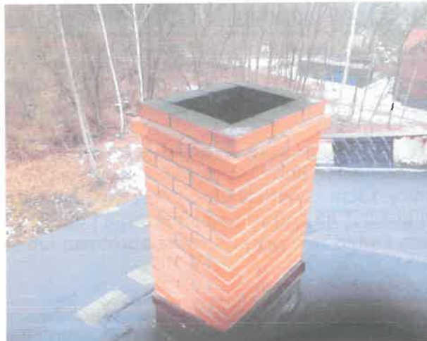
Komin ponad dachem w stanie bardzo dobrym
